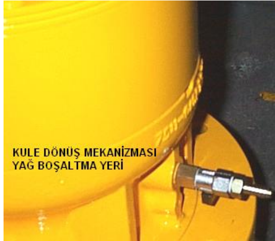
Resim7.2: Kule dönüş mekanizması yağ boşaltma yeri
